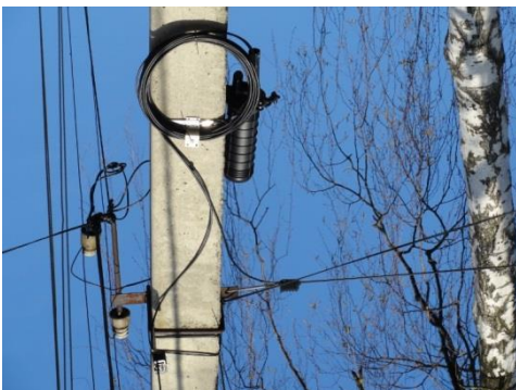
Glasfaserkabel zwischen den Gebäuden
