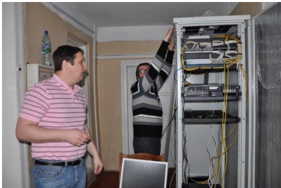
Anschliessen der Server
