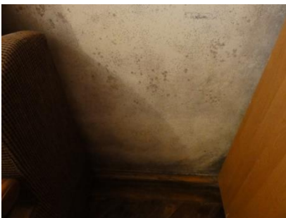
Schimmel an den Wänden
